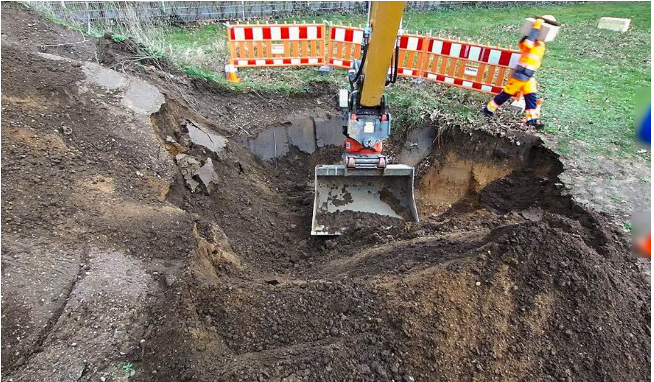
Abb. 1: Zu sehen ist eine nachgestellte Baustellensituation. Im Bild oben rechts befindet sich eine Person im Gefahrenbereich der Baumaschine.
